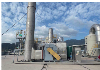
廈暉廠廢氣處理設施
